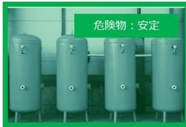
危険物の監視
