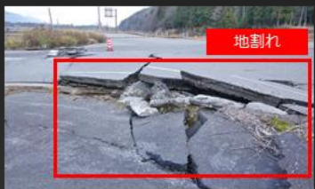
路上異常検出
